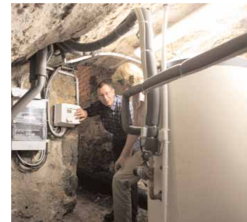
Elektromeister Roland Kiel erklärt die Wärmepumpe: Über Rohre gelangt die Wärme in den Pufferspeicher mit Wasser.
