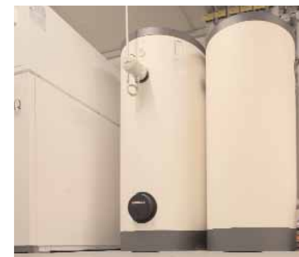
Neben der eigentlichen Luft-Wasser-Wärmepumpe stehen die Pufferspeicher mit heißem Brauch- und Heizwasser.
